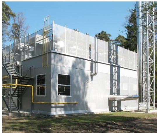
Энергокомплекс на крыше здания ООО «Петербургтеплоэнерго», г. Зеленогорск Электрическая мощность: 1,5 МВт
